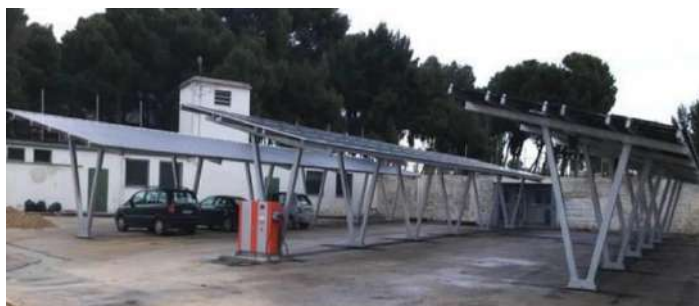
Figura 66. Impianto fotovoltaico nel laboratorio PrInCE
